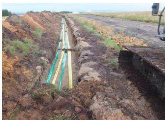
Fotografia 2.16 – Exemplo de uma vala de cabos elétricos
